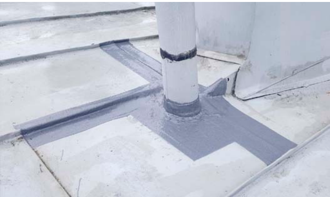
▲ Tuuletusputken juuren tiivistys hormin yläpuolella, jossa useita vuotokohtia.
